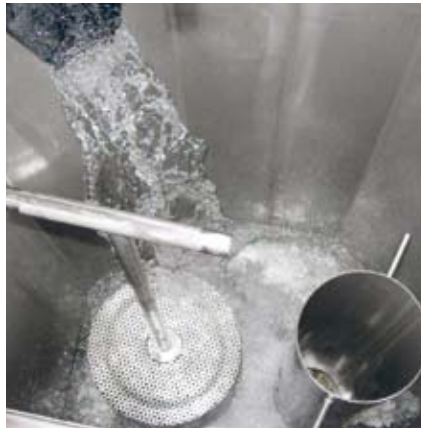
Moderne Quellwasserfassung in Valbella
