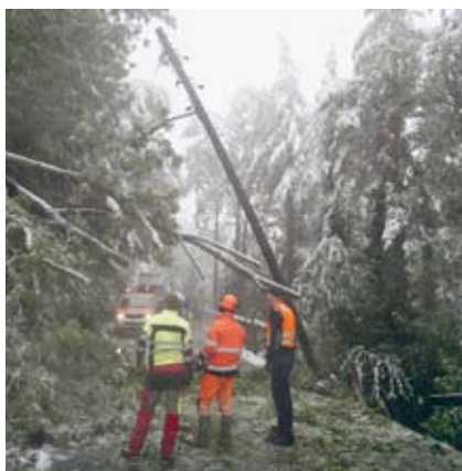
Durch die Schneelast stürzten Bäume um und rissen die Niederspannungsfreileitung der IBC mit.
