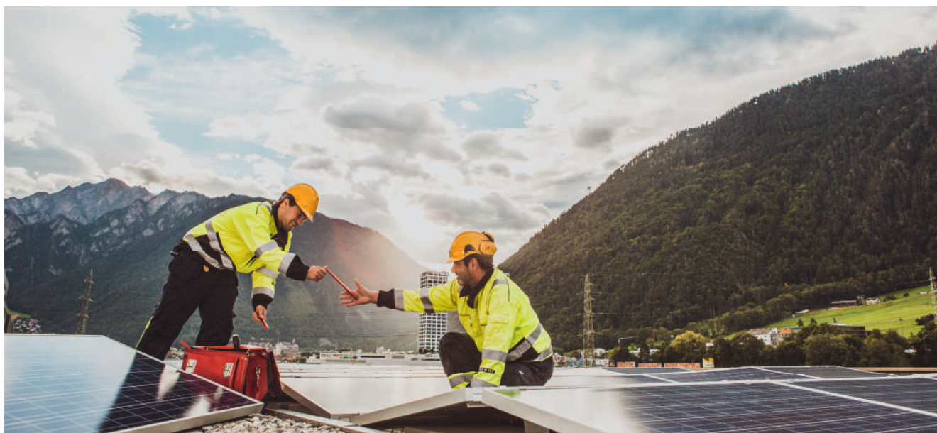
Wartung Photovoltaik-Anlage, Medienhaus Samedia
