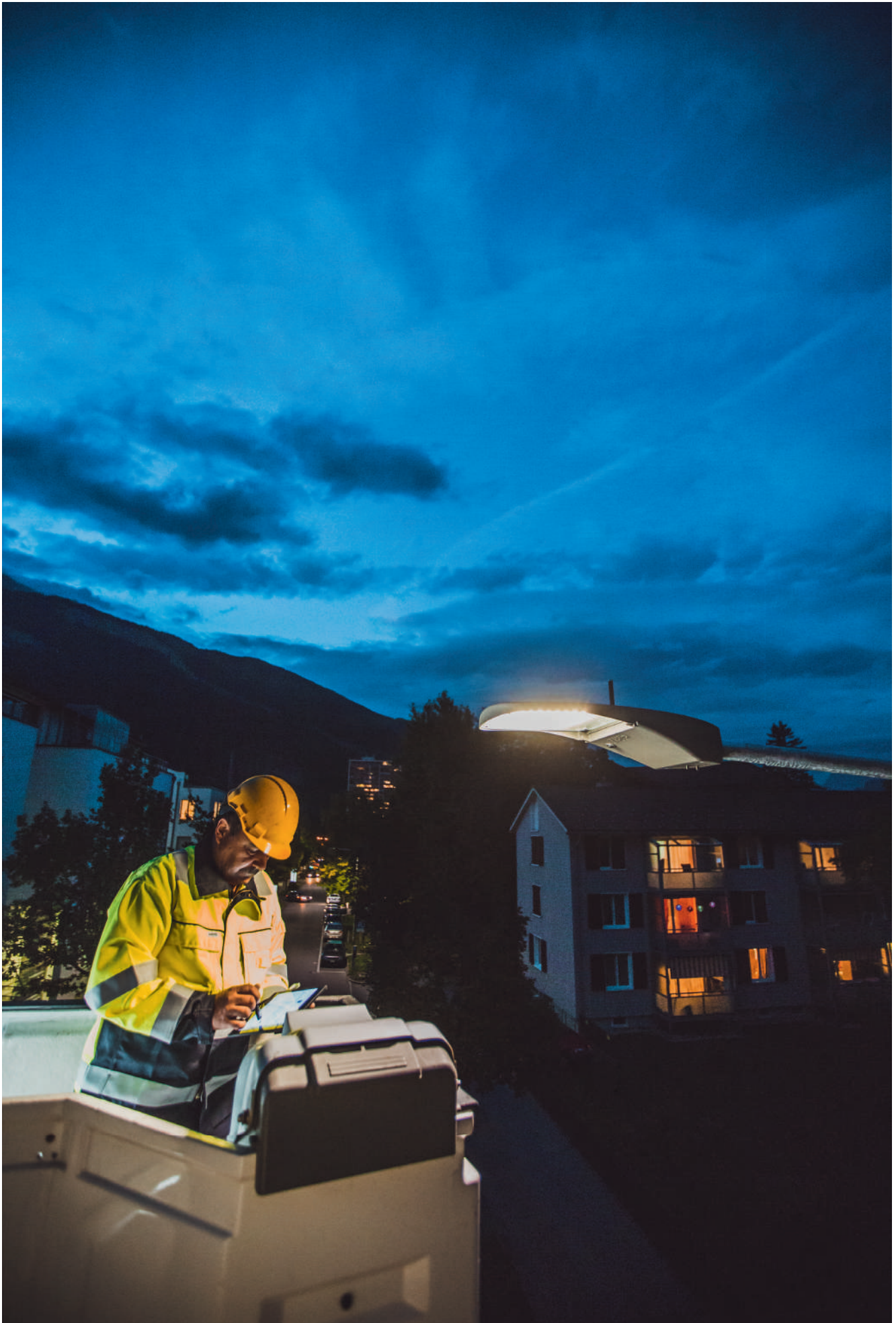
Test einer neu installierten LED-Leuchte
